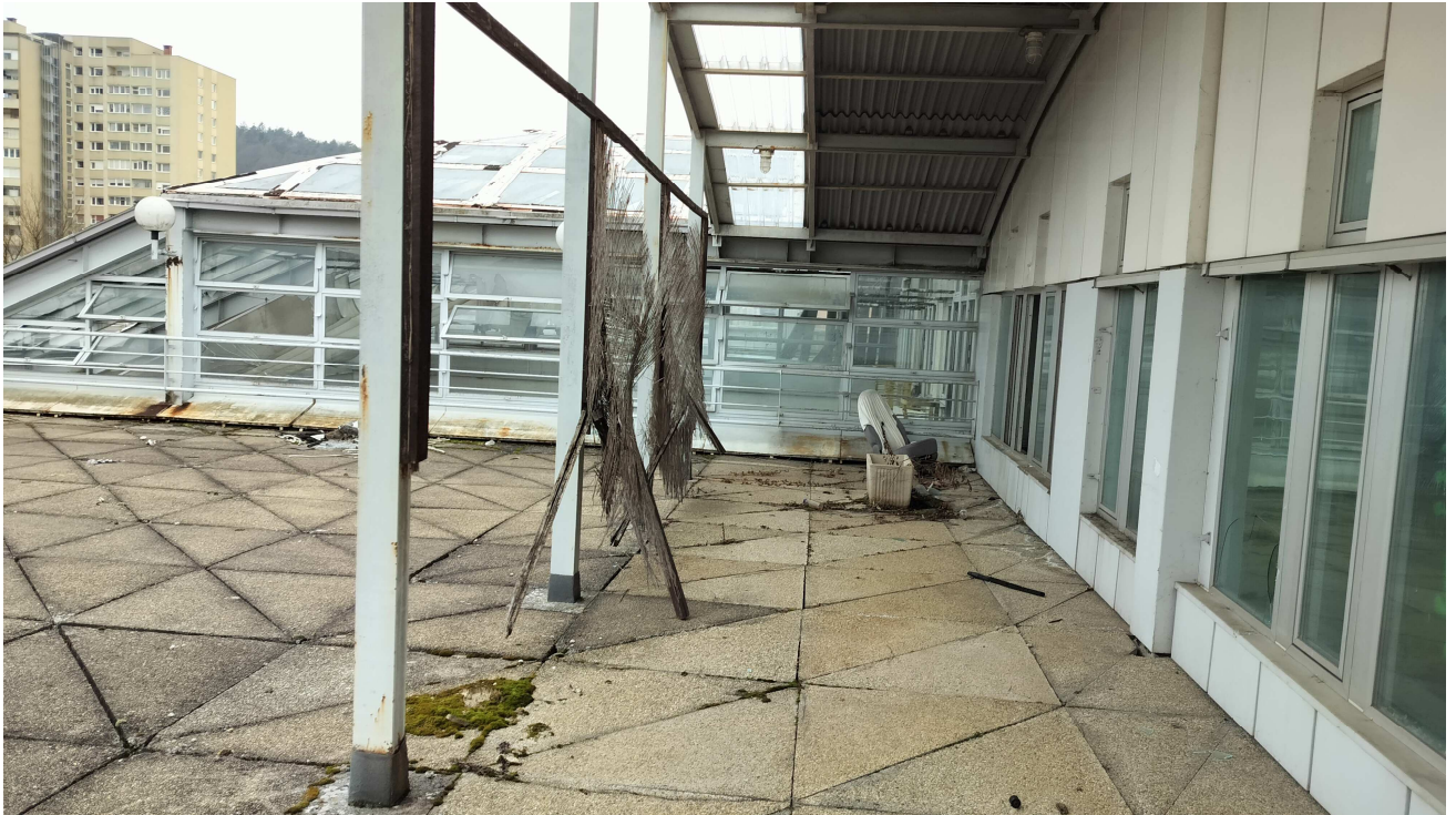
FOTOGRAFIJA št. 8: Pogled iz prejšnjega stojišča nekoliko naprej in nato desno v smeri vzhod - zahod. Desno od kovinskih stebričkov strebe je Pokrita terasa 2, levo pa Streba. Oboje je dejansko odprta terasa, tlakovana z betonskimi pobodnimi ploščami.
