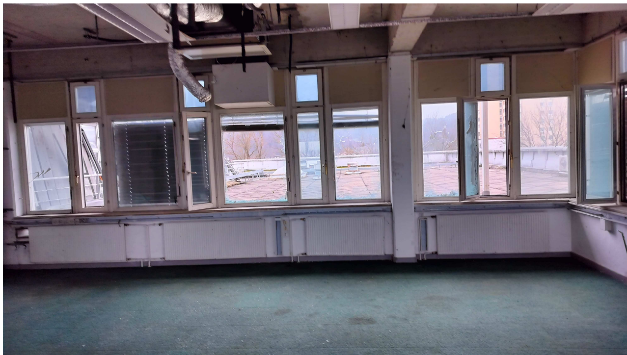
FOTOGRAFIJA št. 12.: Pogled iz sredine prostora Jedilnica 1 (tloris 2. nadstropja – št. risbe 05) v smeri sever – jug na Pokrito teraso 1 in Strebo skozi okna Jedilnice 1.
